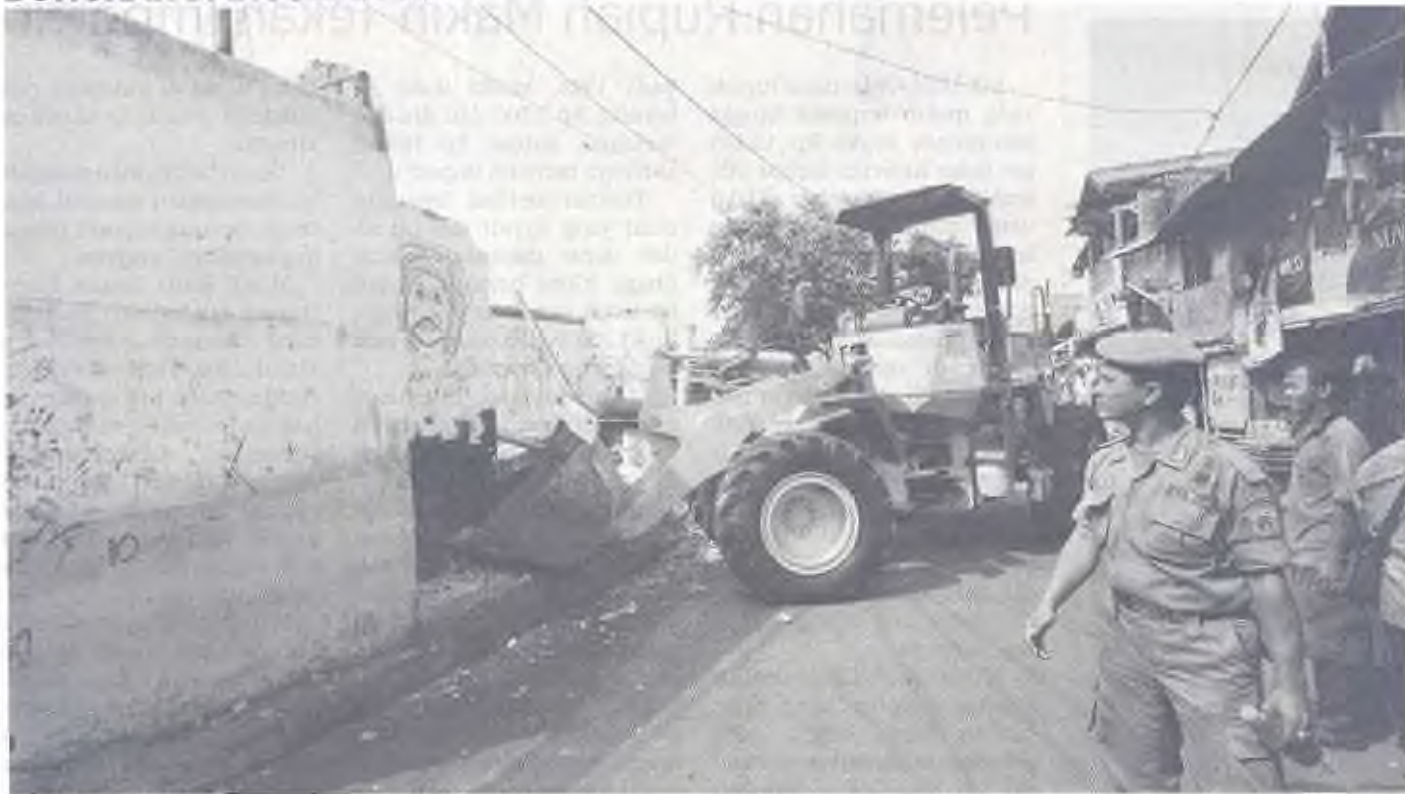
Sejumlah bangunan liar di sisi Kali Sentong di RT 01/13 Kelurahan Tanah Tinggi, Kecamatan Johar Baru, Jakarta Pusat dibongkar aparat Pemerintah Provinsi DKI Jakarta, Jumat (5/6). Pembongkaran tersebut dilakukan guna menciptakan keindahan kota. SH/Edy Wahyudi
