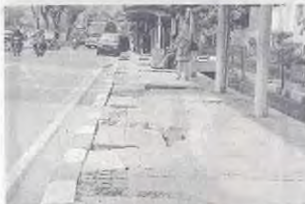
Kondisi trotoar di Jalan Cempaka Putih.
