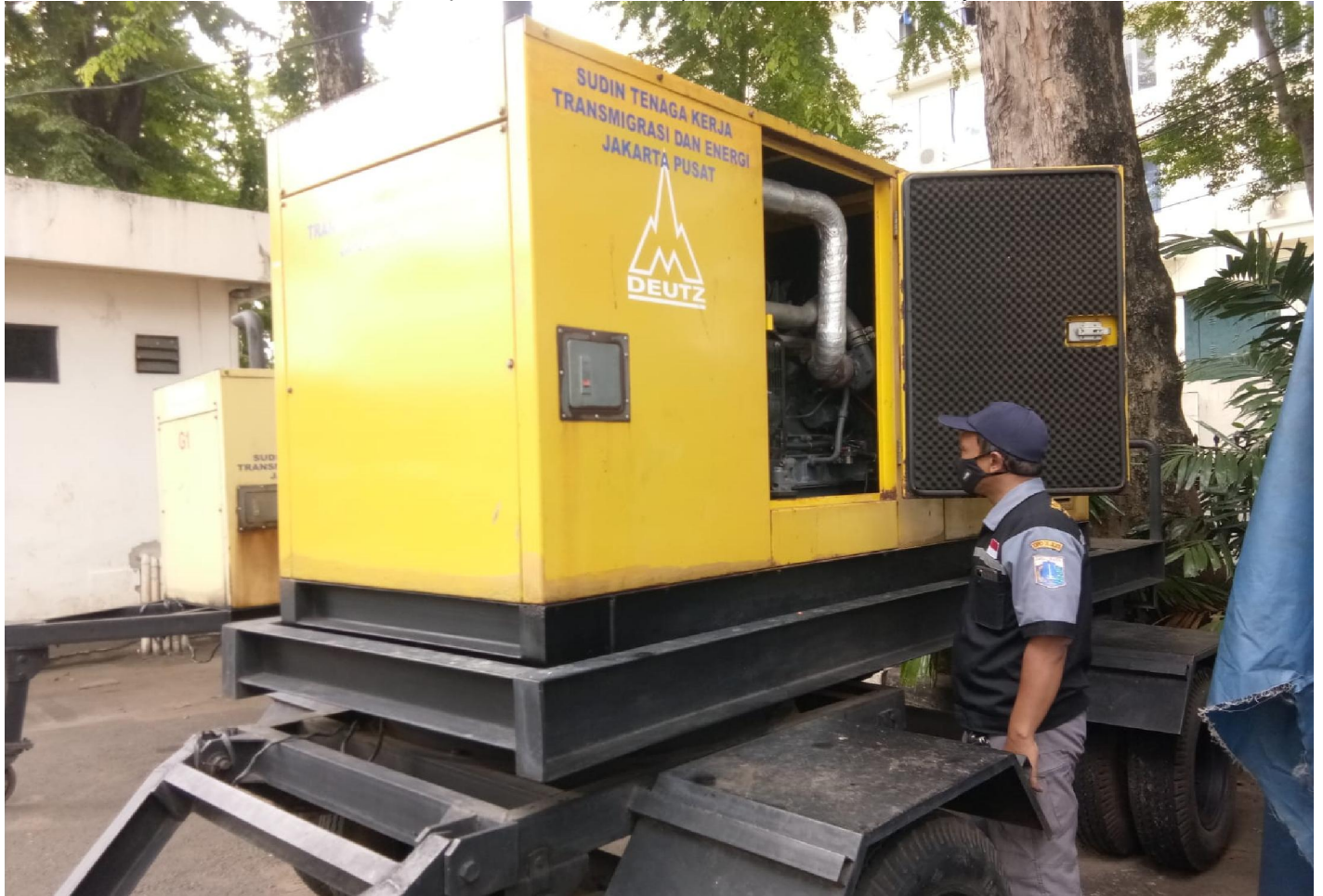
Pemeriksaan rutin kesiapan genset. Foto: H. A. Daelani
